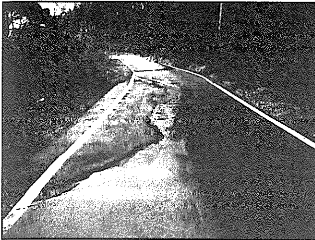
写真-1. 観測開始当時の頭部亀裂 (2/16)
