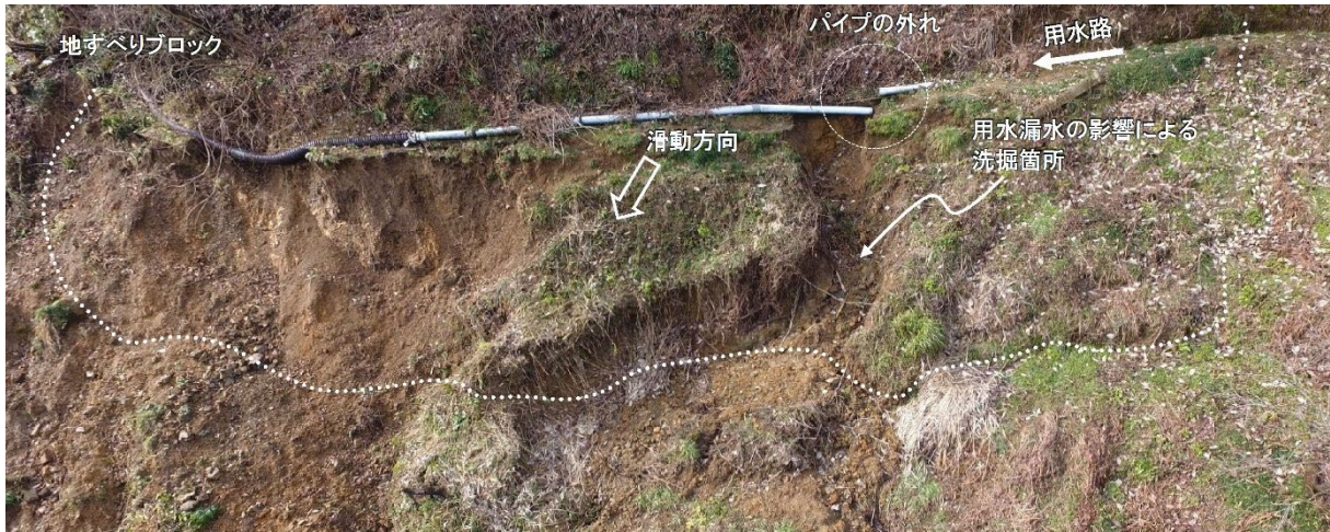
図-2 地すべり末端部での表層崩壊
